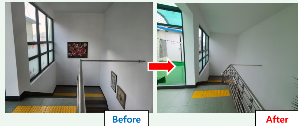
누수로 오염된 벽 및 내부 도장부위 보강 조치
